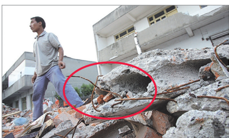
四川地震学校的建筑梁栋为空心水泥、钢筋竟是“细铁丝”
